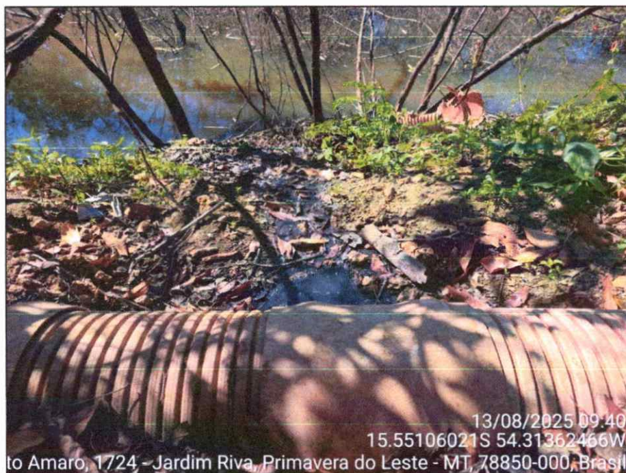
Imagem 02: Evidência de Extravasamento.
