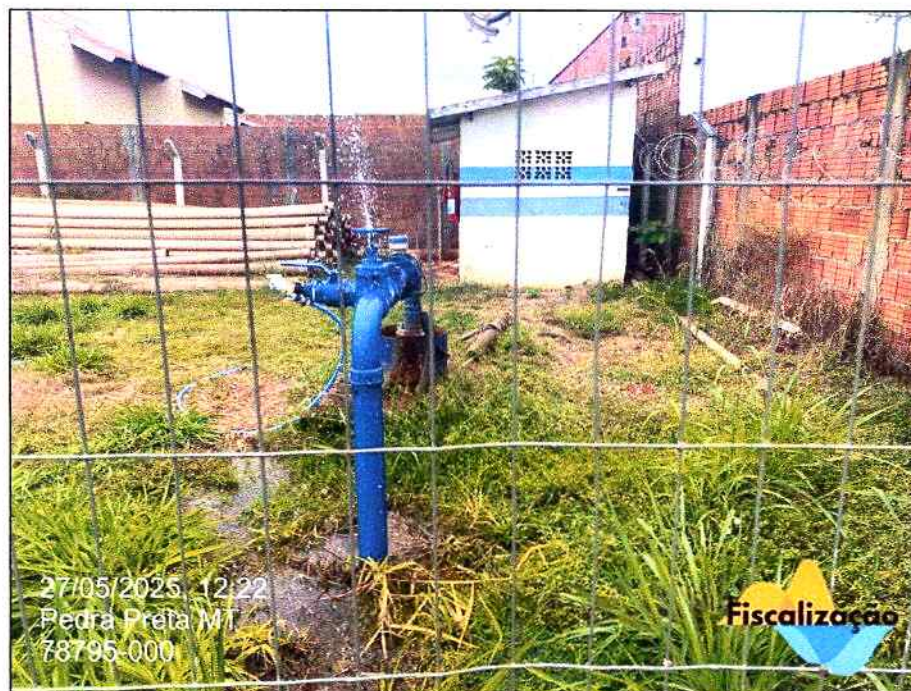
Imagem 04: Detalhe de vazamento no barrilete.
