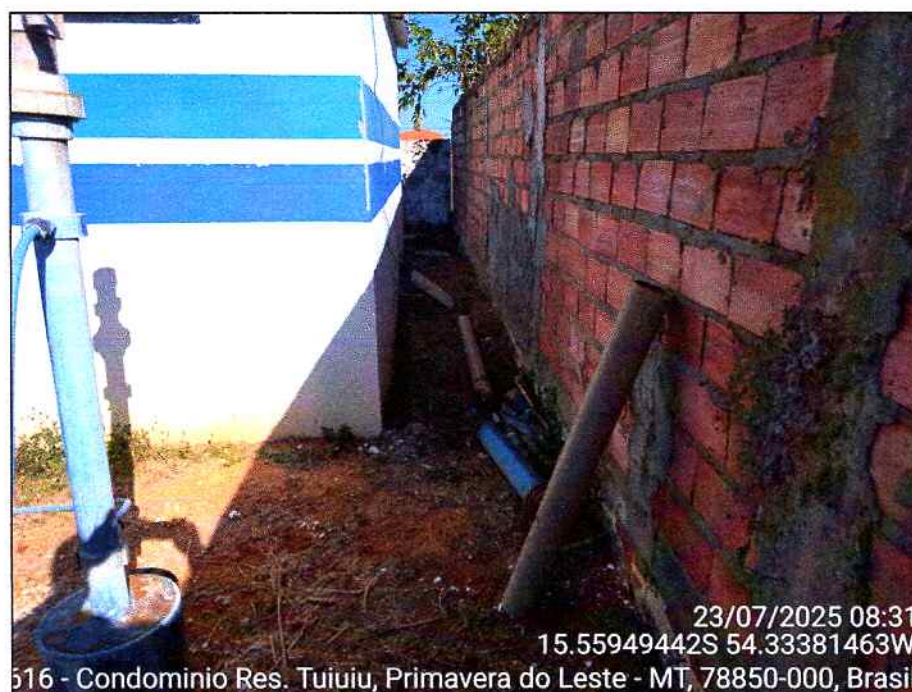
Imagem 05: Detalhe de pedaço de tubulações.
