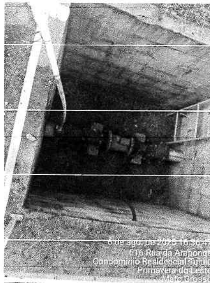
Figura 1: Vazamento e limpeza realizados.
