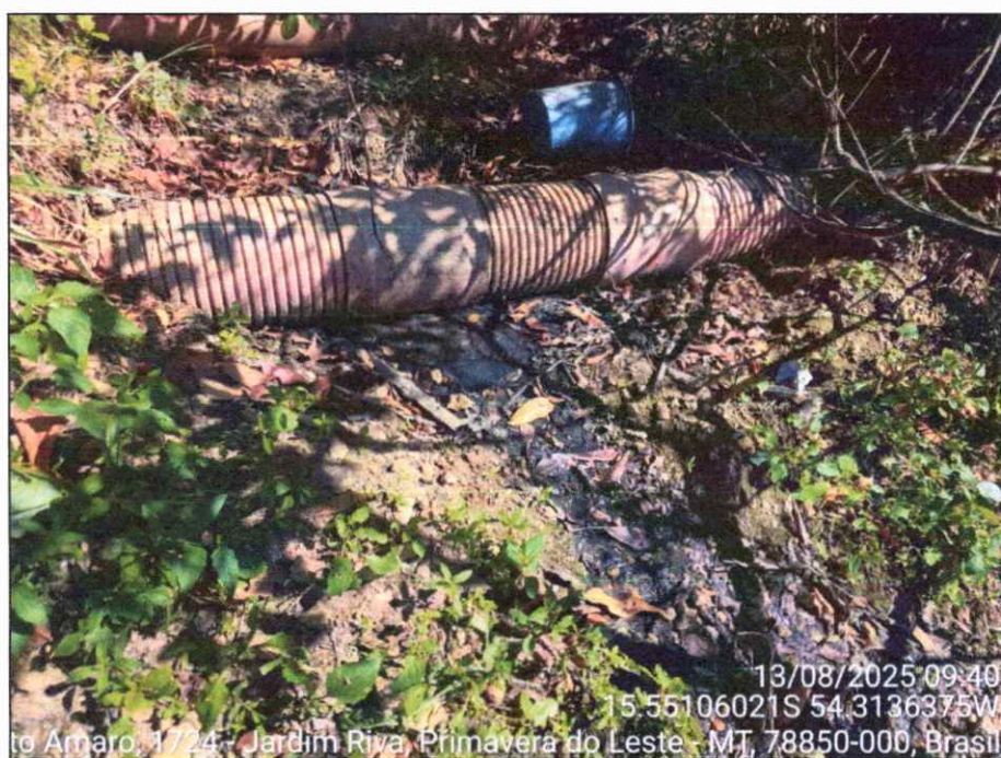
Imagem 01: Evidência de Extravasamento.
