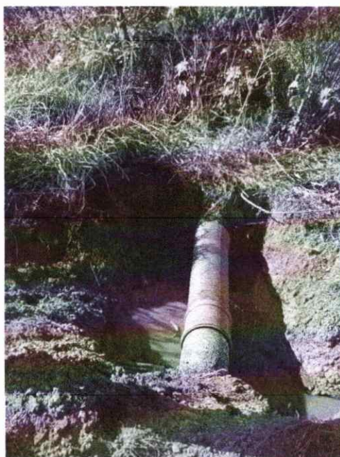
Figura 1: Tubulação concertada na área da Central de Recolhimento de Podas.
