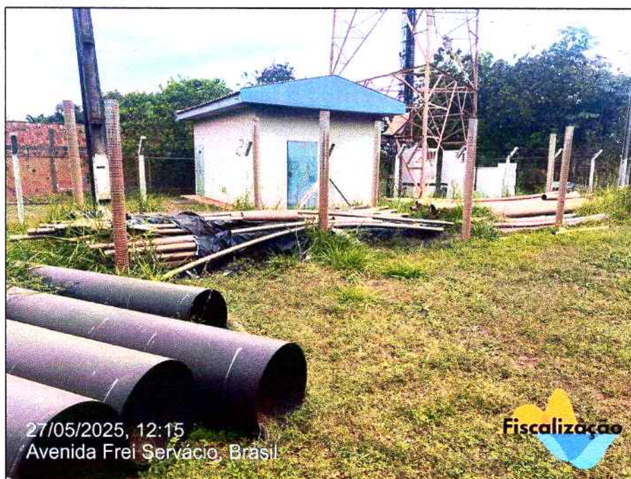
Imagem 03: Detalhe de tubos expostos.
