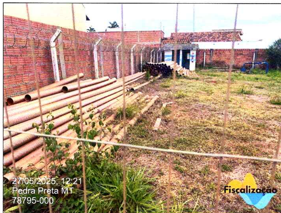
Imagem 02: Detalhe de tubos expostos.
