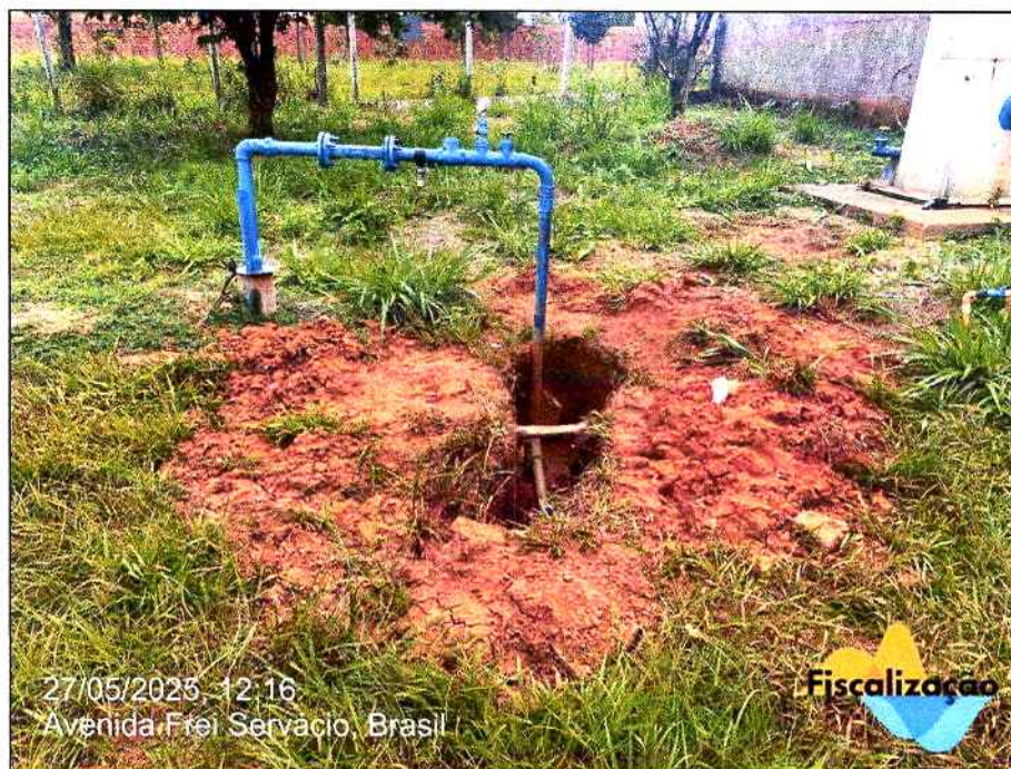
Imagem 04: Detalhe de buraco exposto.
