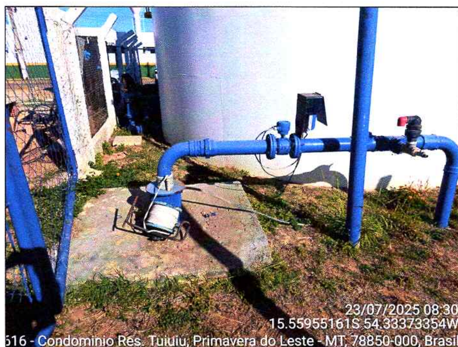
Imagem 04: Detalhe de medidor de nível.
