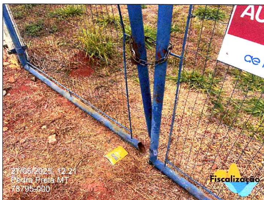
Imagem 03: Detalhe do tubo da proteção do portão de entrada quebrado.
