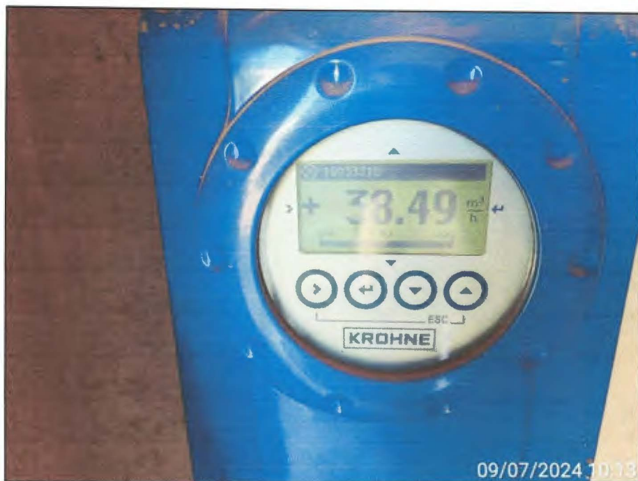
Imagem 35: Detalhe da vazão do PTP 11.
