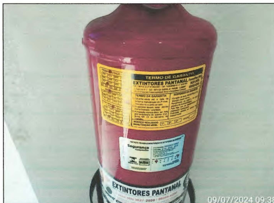
Imagem 06: Detalhe do extintor de incêndio da loja vencido.
