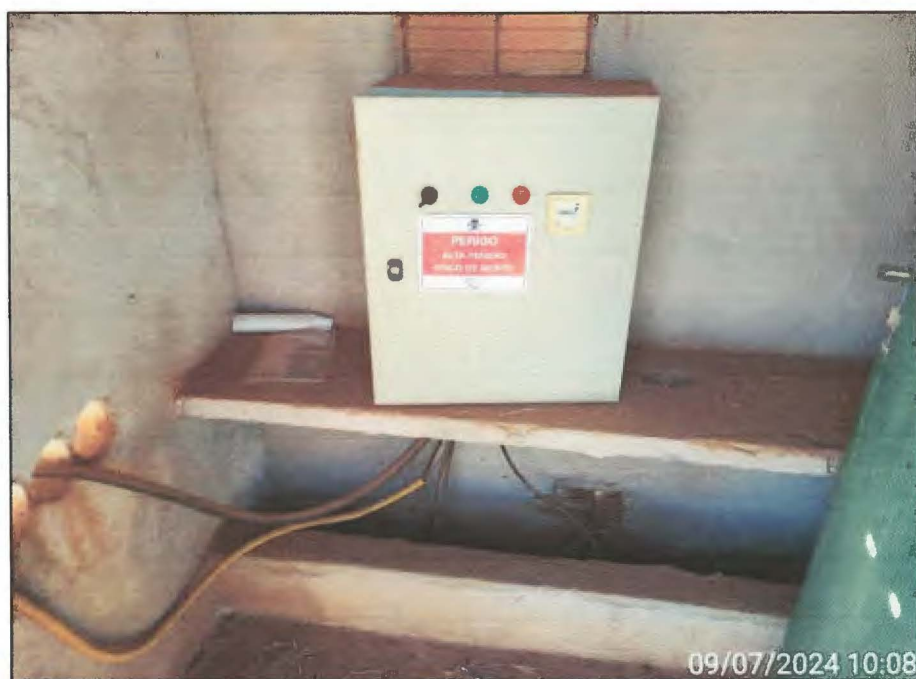
Imagem 36: Detalhe do quadro de comando do PTP 11.
