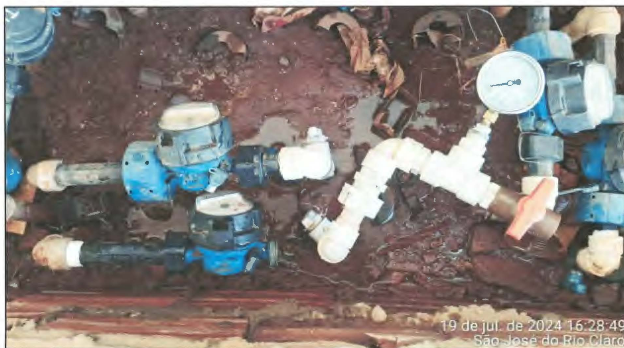
Imagem 03: Detalhe da pressão de 05 mca aferida no dia 19 de julho de 2024 as 16:28 horas.
