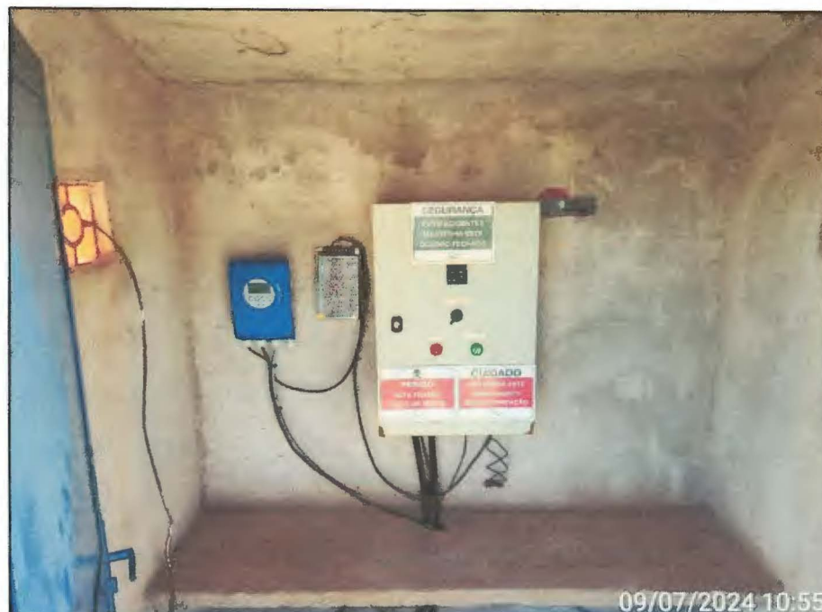
Imagem 65: Detalhes do quadro de comando, do visualizador de vazão do PTP 12 e a ausência de iluminação noturna.
