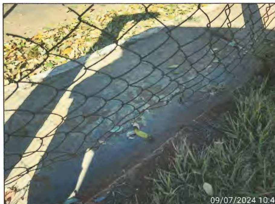
Imagem 62: Detalhe da tela do alambrado danificada na unidade do PTP 12.
