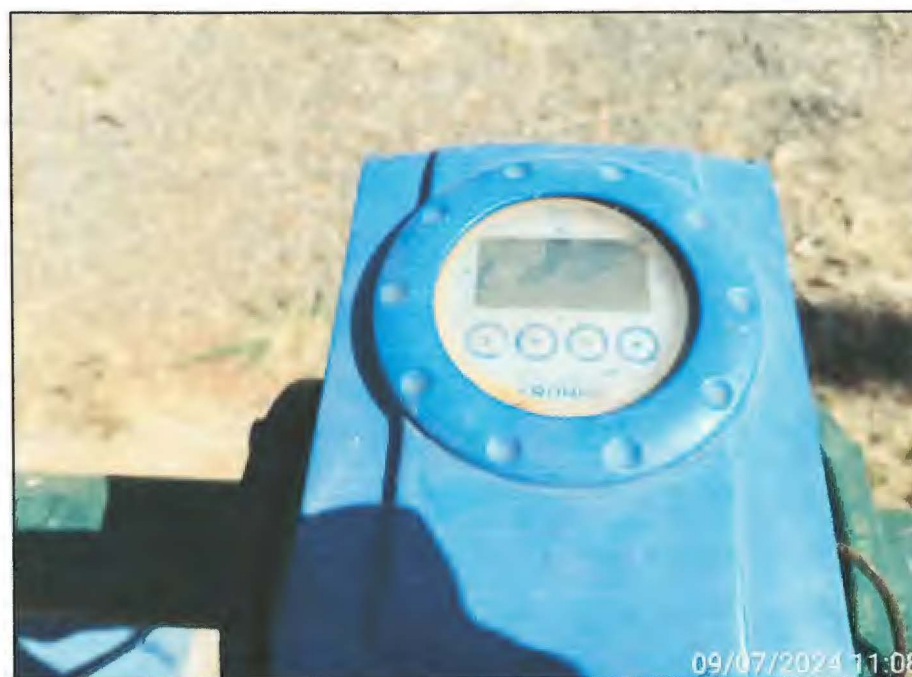
Imagem 70: Detalhe do medidor de vazão do PTP 10 danificado.
