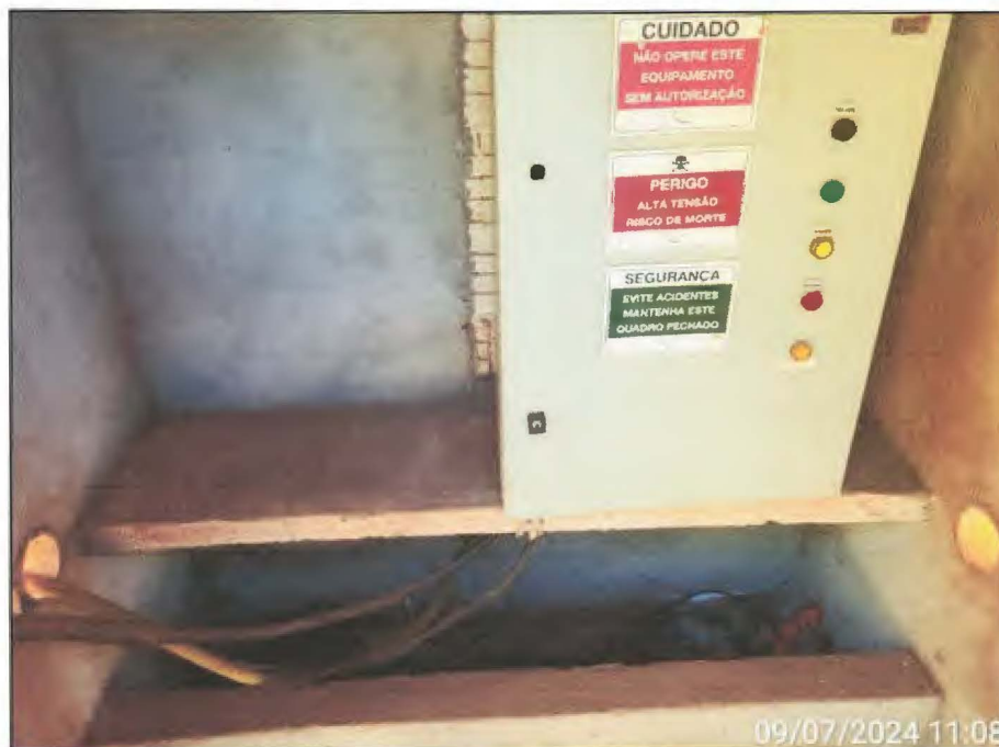
Imagem 71: Detalhes do abrigo do quadro de comando e ausência de iluminação noturna.
