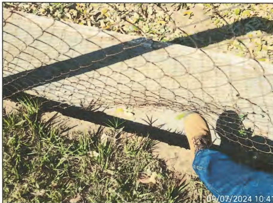
Imagem 63: Detalhe da tela do alambrado danificada na unidade do PTP 12.
