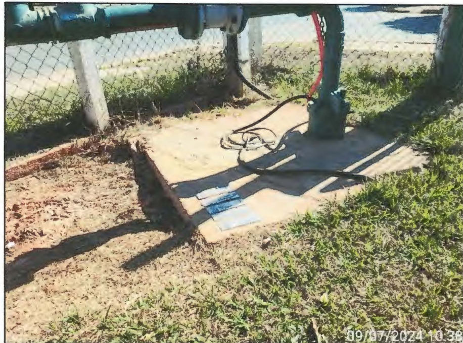
Imagem 55: Detalhes da laje de proteção do PTP 04 semienterrada e da fiação elétrica exposta.
