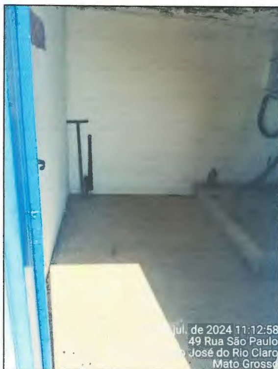
Imagem 85: Detalhe EAT Jardim Olinda sem as massas asfálticas. Fonte: Águas de São José.
