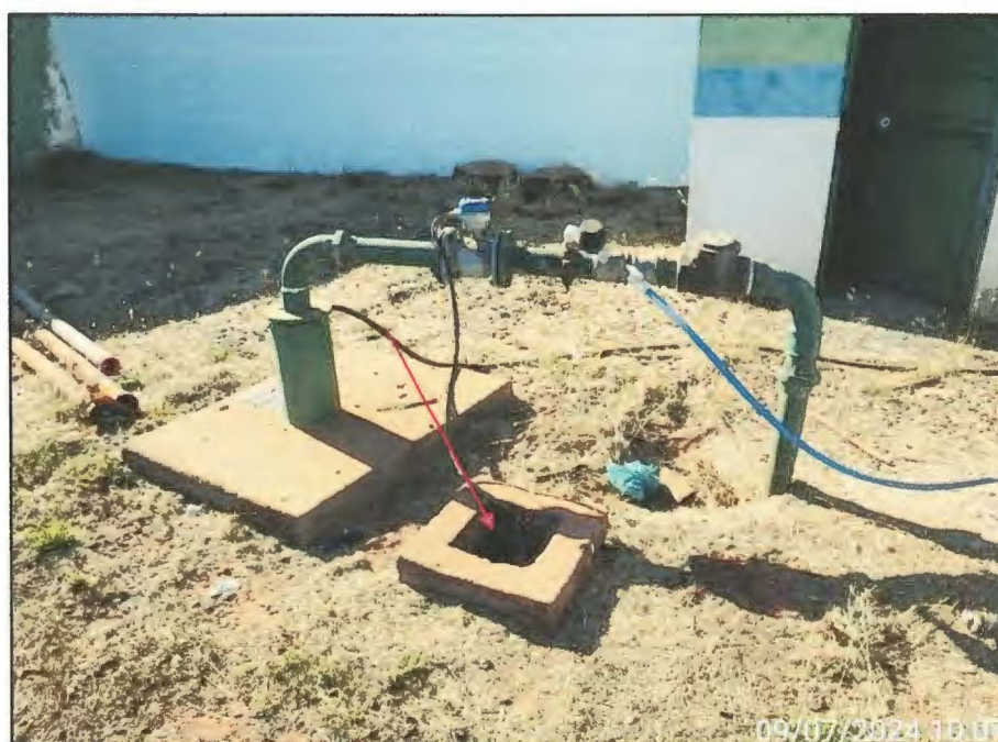
Imagem 34: Detalhe do PTP 11 e destaque para a caixa de passagem desprotegida.
