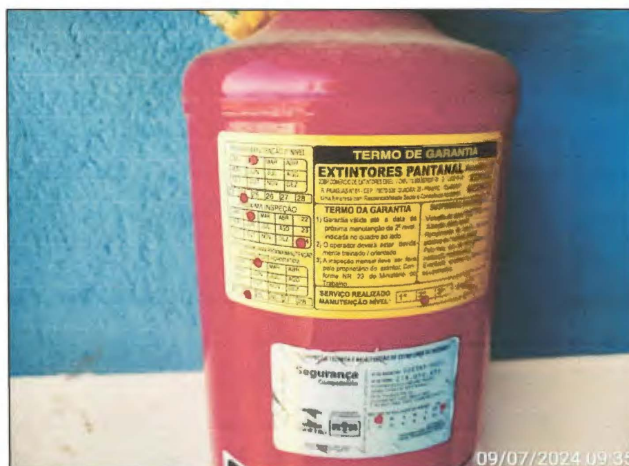
Imagem 22: Detalhe do extintor de incêndio vencido da sala do almoxarifado.
