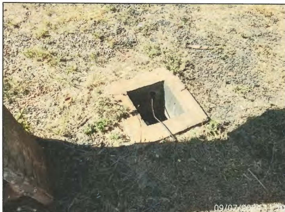
Imagem 75: Detalhe da caixa de passagem sem tampa ou grade de proteção no pátio da unidade Jardim Olinda.
