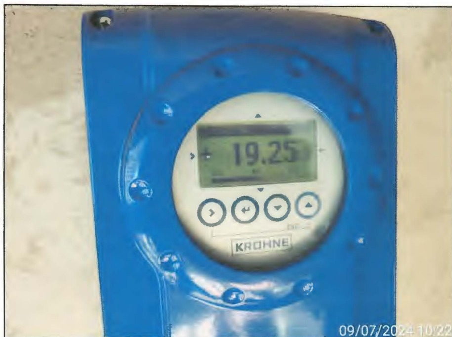
Imagem 47: Detalhe da vazão do PTP 08.
