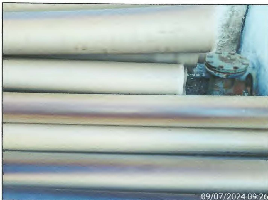
Imagem 29: Detalhe dos desgastes das tubulações com a incidência direta de raios solares.
