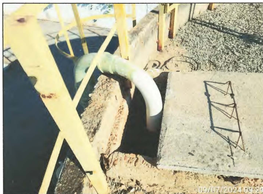
Imagem 16: Detalhe do poço de visita na laje de cobertura do RAP Sede.
