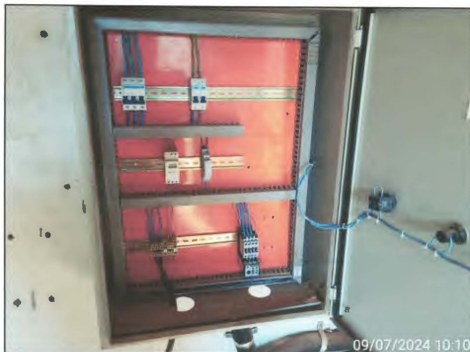
Imagem 41: Detalhe do quadro de comando da EAT P. Coelho desativado.
