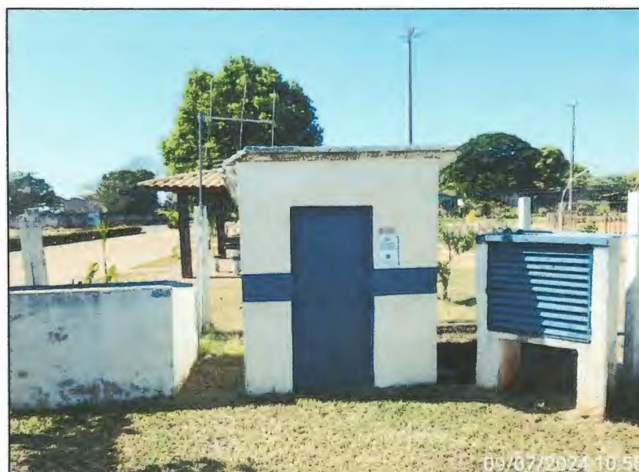
Imagem 64: Detalhe do abrigo dos quadros de comando do PTP 12.
