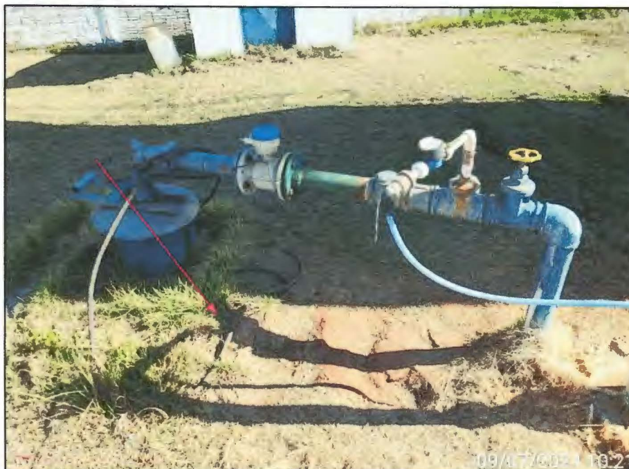
Imagem 45: Detalhe do PTP 08 e destaque para a laje de proteção do poço enterrada.
