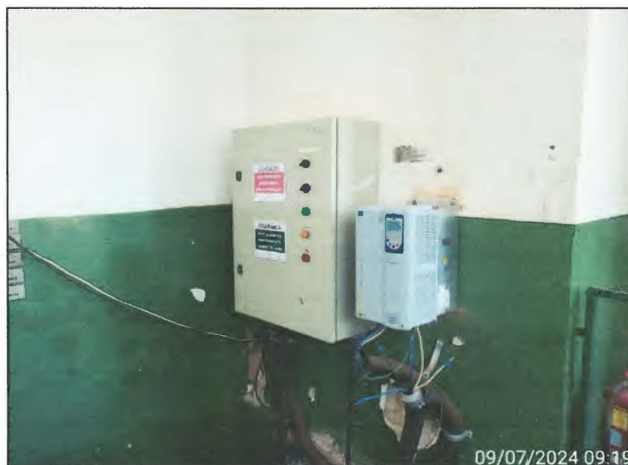
Imagens 12: Detalhes do quadro de comando das bombas e do inversor de frequência da bomba principal.
