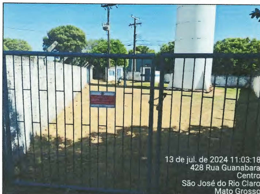
Imagem 83: Detalhes do pátio da EAT Prefeitura sem a bombona de produto químico. Fonte: Águas de São José.
