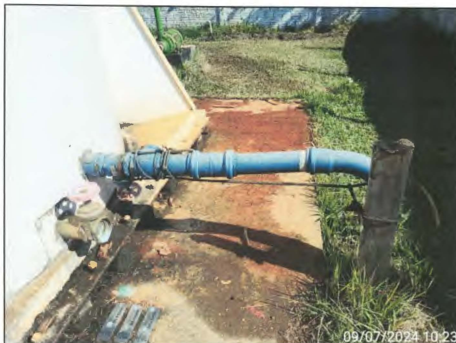
Imagem 51: Detalhe da tubulação de saída do RAP Prefeitura amarrada com corda e escorada com tábua de madeira.
