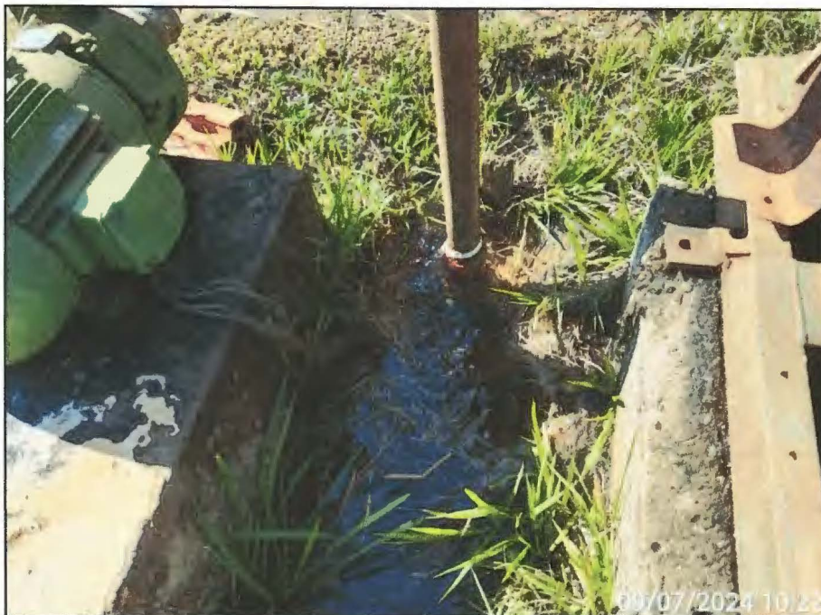
Imagem 49: Detalhe do vazamento na tubulação da EAT desativada da unidade PTP 08.
