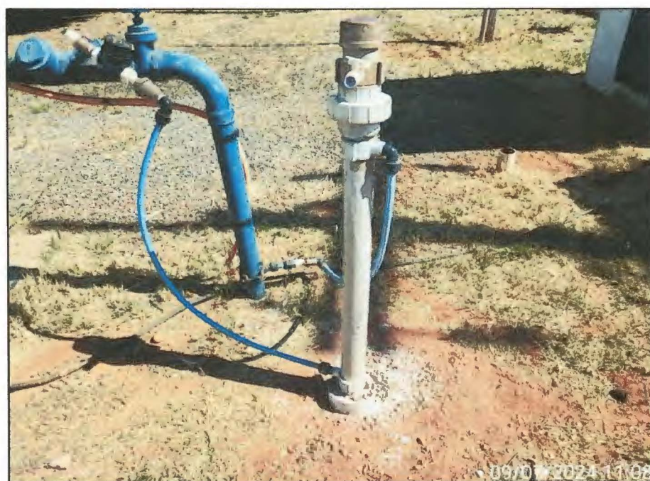
Imagem 76: Detalhe do dosador 01 da unidade Jardim Olinda.
