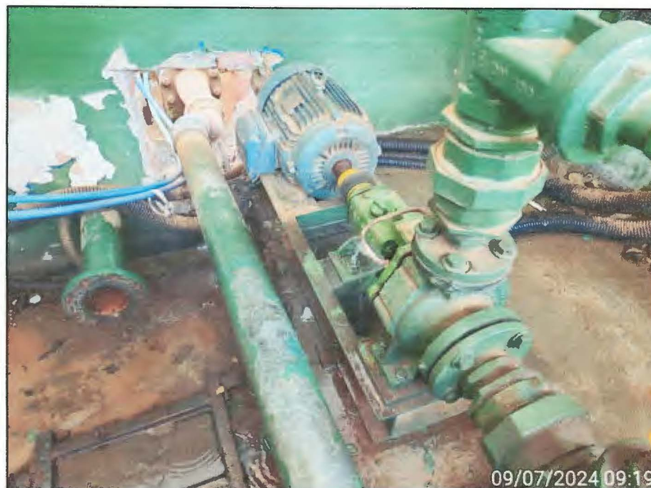
Imagem 11: Detalhe do vazamento de água tratada na bomba da EAT Sede.
