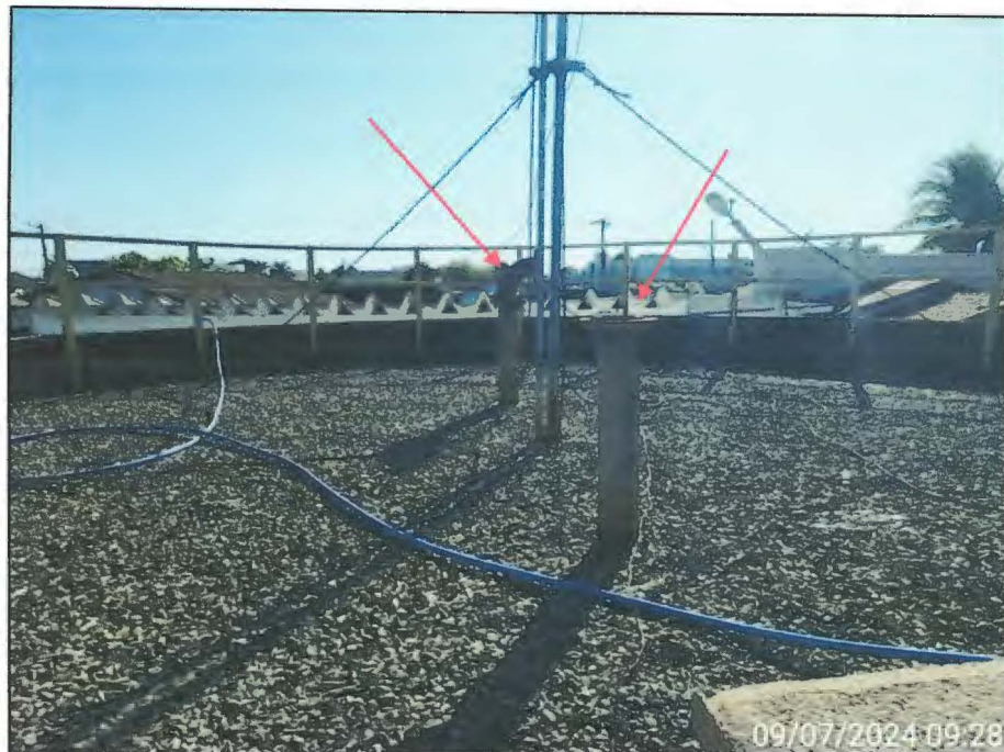
Imagem 17: Destaque para as tubulações de ventilação na laje de cobertura do RAP Sede sem extensão em curva e/ou telas de proteção.
