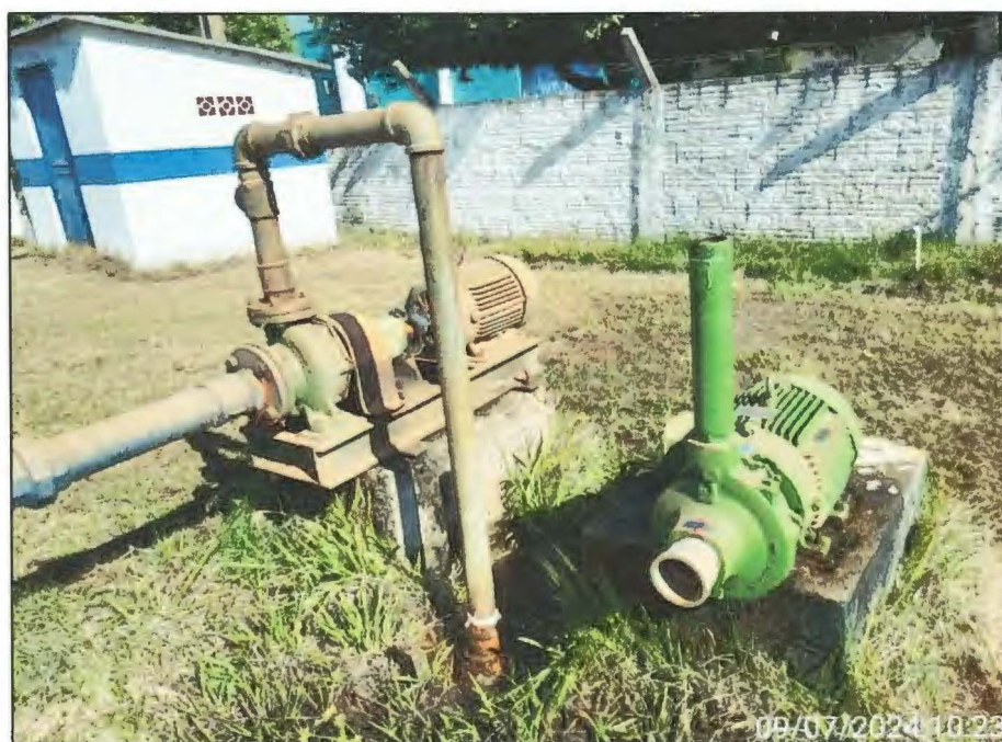
Imagem 48: Detalhe da EAT desativada na unidade PTP 08.
