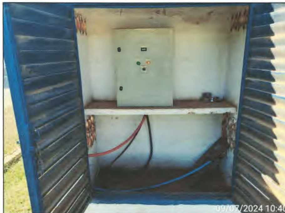
Imagem 59: Detalhes do abrigo do quadro de comando do PTP 04 e a ausência de iluminação noturna.
