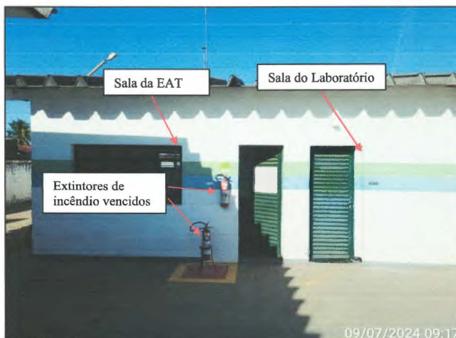
Imagem 08: Destaques para as salas da EAT e do Laboratórios na unidade Sede e, dos extintores de incêndios vencidos.
