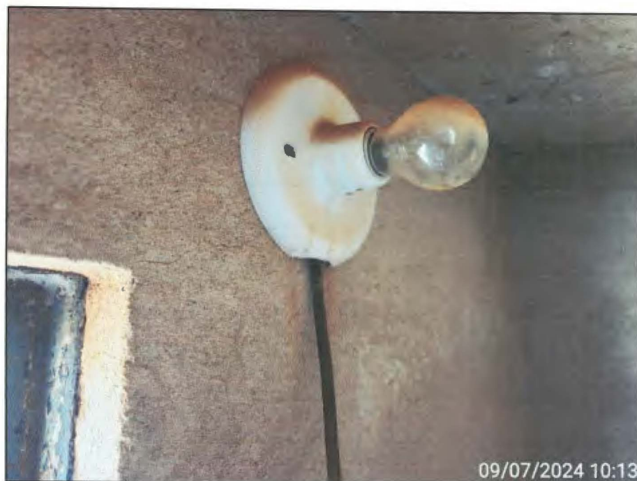
Imagem 39: Detalhe da lâmpada queimada na sala de comandos da unidade P. Coelho.
