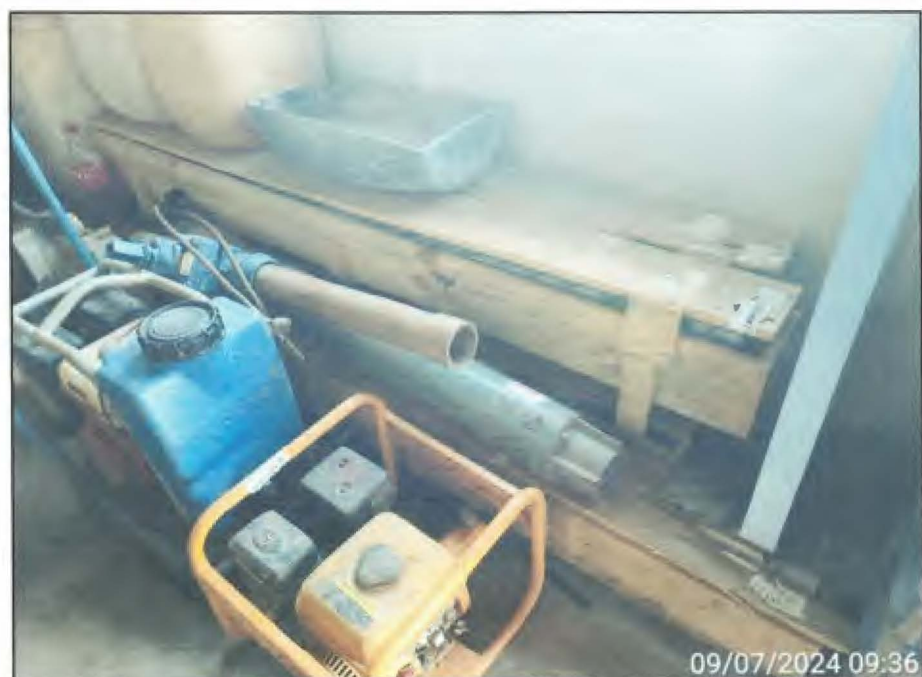
Imagem 24: Detalhe das bombas reservas dos poços.
