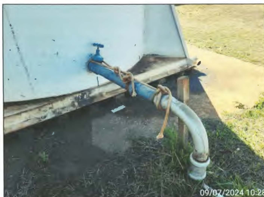
Imagem 52: Detalhe da tubulação de saída do RAP Prefeitura amarrada com corda e escorada com tábua de madeira.
