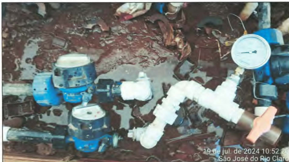
Imagem 02: Detalhe da pressão de 06 mca aferida no dia 19 de julho de 2024 as 10:52 horas.
