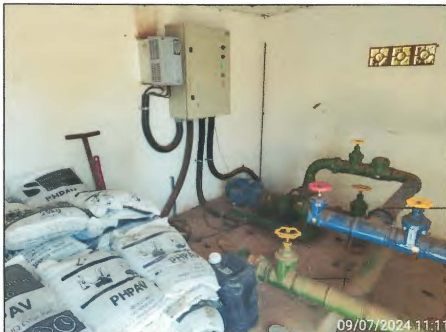
Imagem 73: Detalhes da EAT Jardim Olinda e destaques para o armazenamento de massa asfáltica e para a ausência de conjunto motobomba reserva instalado.
