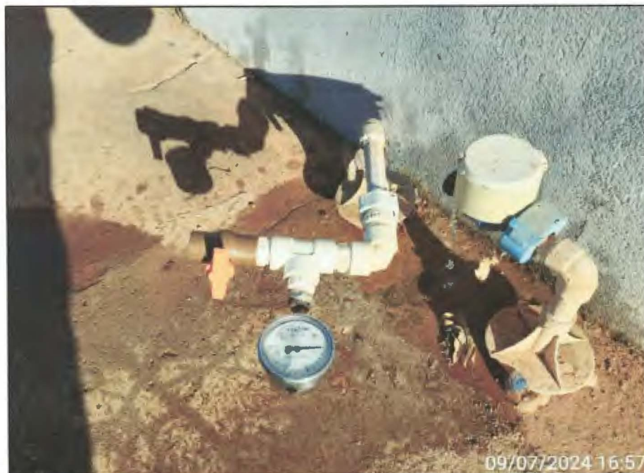
Imagem 80: Detalhe do monitoramento de pressão na rede de distribuição do SAA.
