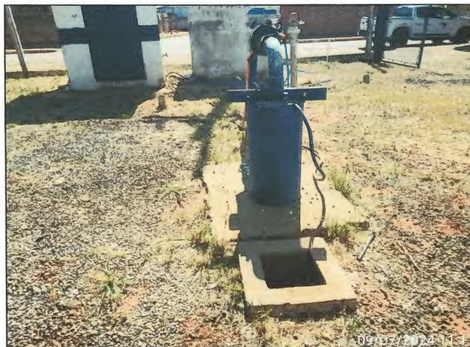
Imagem 74: Detalhe da caixa de passagem sem tampa ou grade de proteção na unidade Jardim Olinda.
