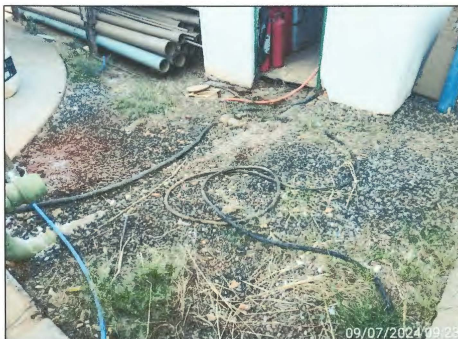
Imagens 30: Detalhe das fiações elétricas expostas no pátio da unidade Sede.
