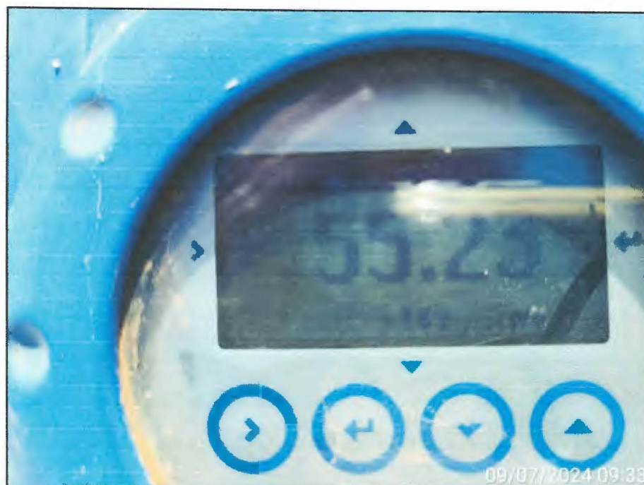
Imagem 21: Detalhe da vazão do PTP 09.
