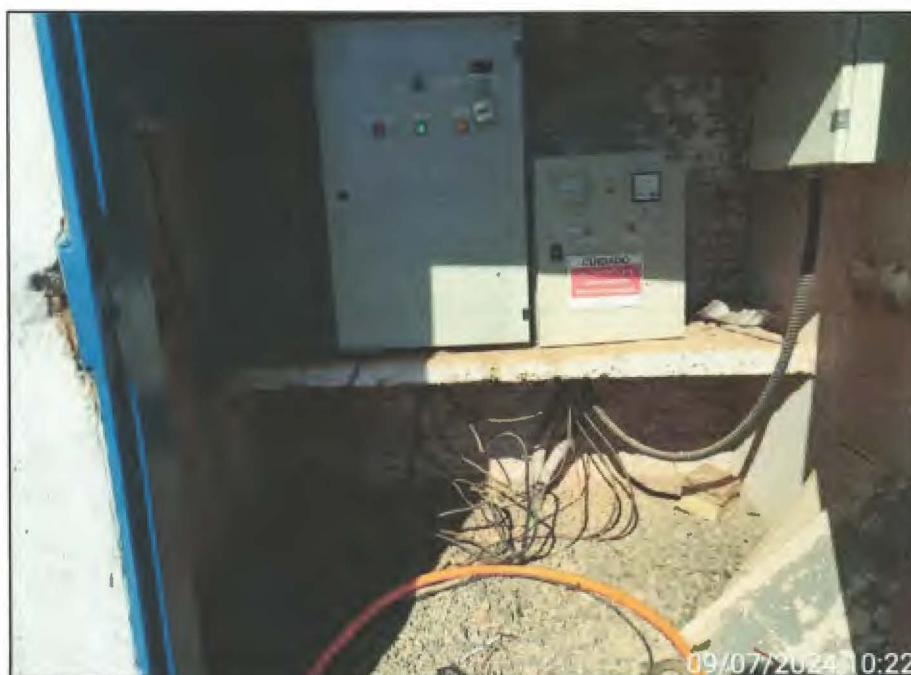
Imagem 44: Detalhes do abrigo dos quadros de comandos do PTP 08 e a ausência de iluminação noturna.
