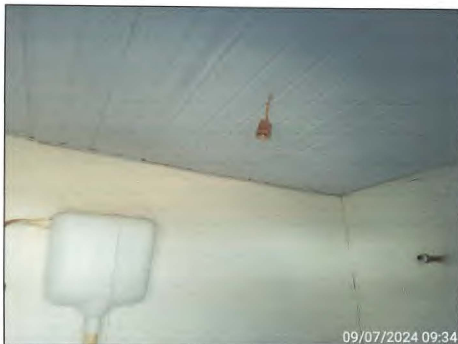
Imagem 25: Detalhe da ausência de lâmpada no banheiro do almoxarifado.
