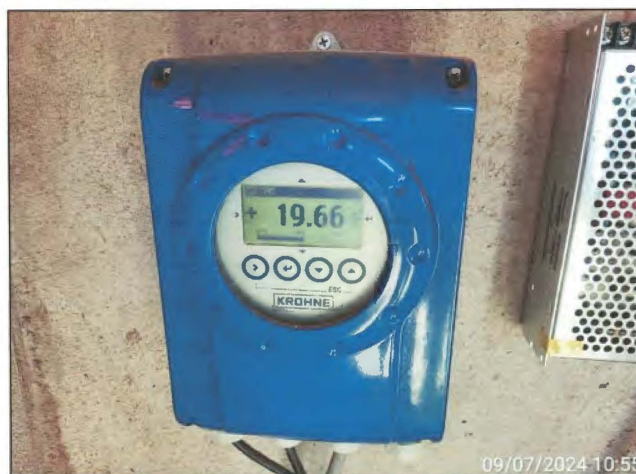
Imagem 66: Detalhe da vazão do PTP 12.
