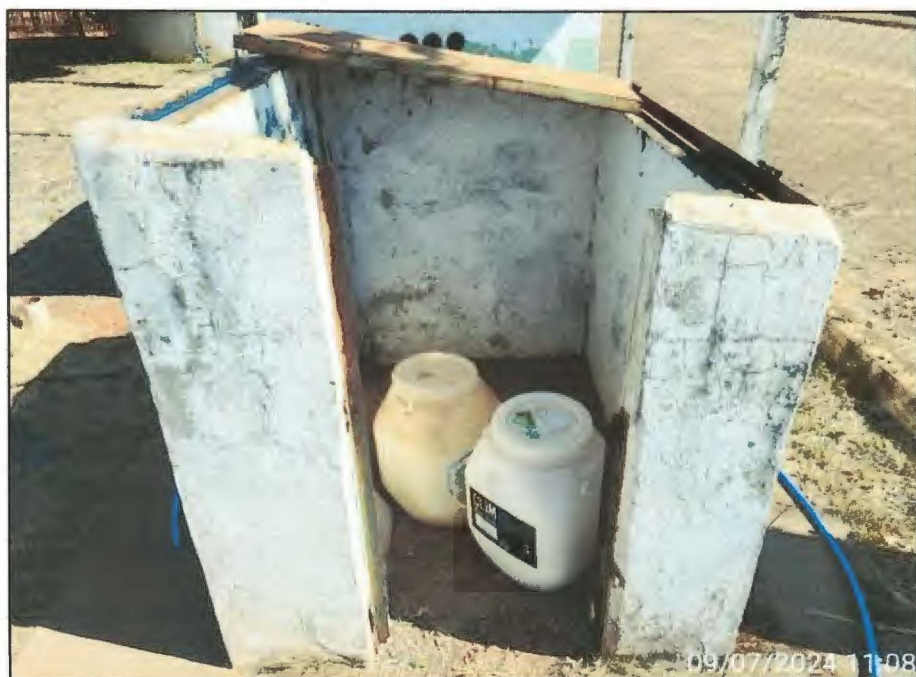
Imagem 78: Detalhe das bombonas de produtos químicos armazenados no piso.
