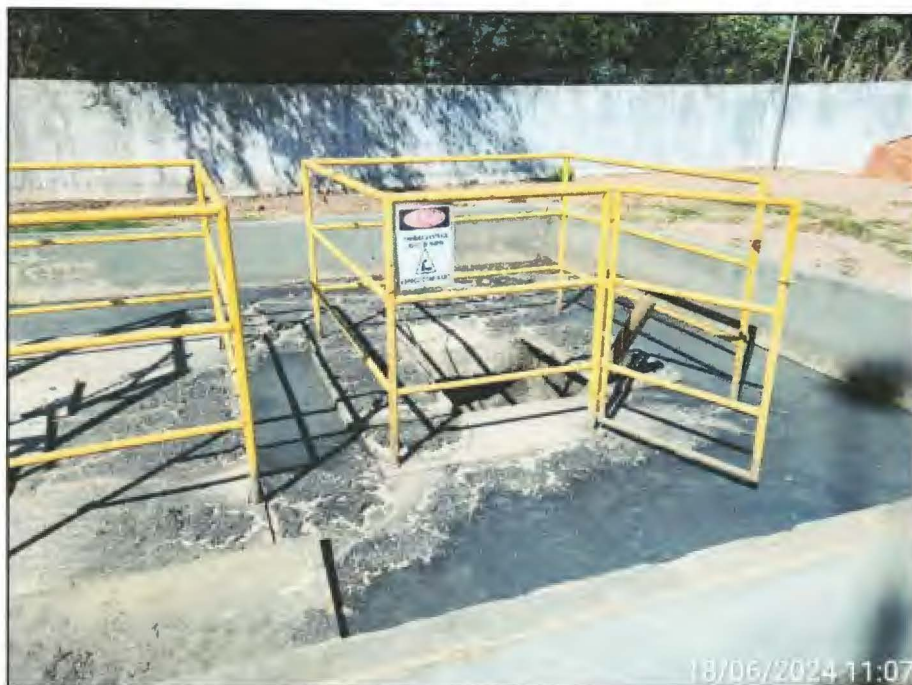
Imagem 01: Detalhe do derramamento de esgoto no espaço dos poços da elevatória Albatroz.
