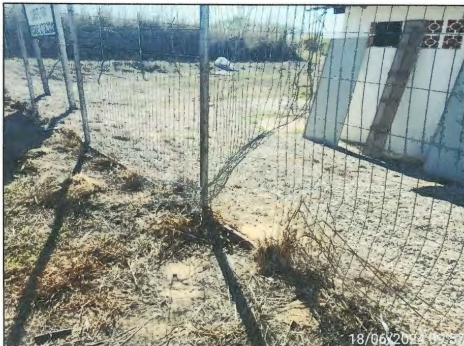
Imagem 05: Detalhe da tela do alambrado danificada na elevatória Greenville.
