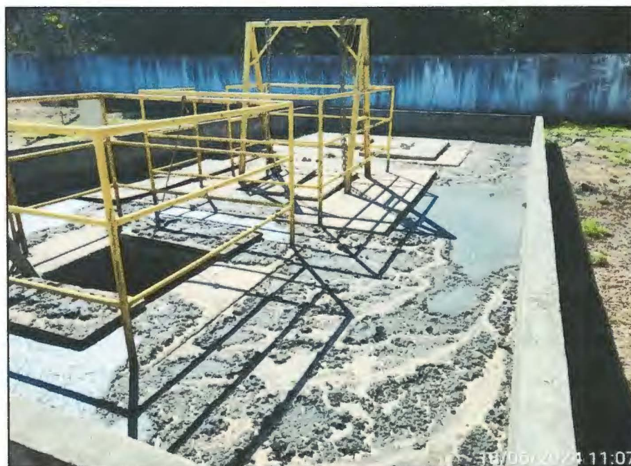
Imagem 02: Detalhe do derramamento de esgoto no espaço dos poços da elevatória Albatroz.
