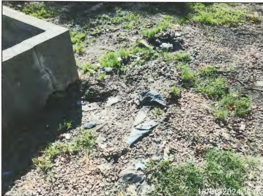
Imagem 03: Detalhe do derramamento de esgoto no pátio da elevatória Albatroz.
