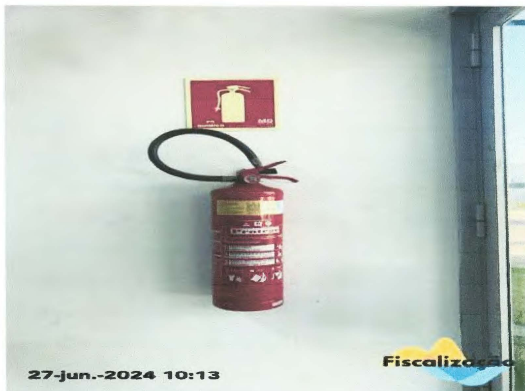
Figura 3: Extintor bem localizado.
