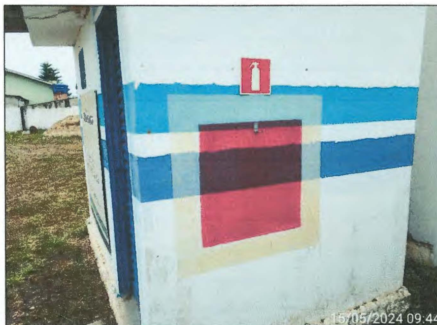
Imagem 06: Detalhe da ausência do extintor de incêndio na unidade PTP 05
