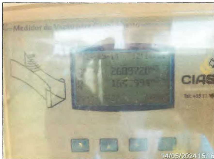
Imagem 09: Detalhe da vazão do esgoto tratado no instante da coleta na ETE Rio das Mortes – 14/05/2024.
