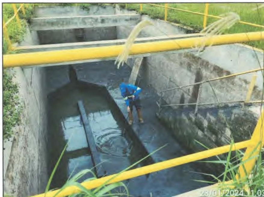
Imagem 01: Detalhe da coleta do esgoto bruto na ETE Rio das Mortes – 23/01/2024.
