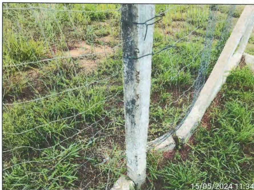
Imagem 35: Detalhe do alambrado danificado na unidade PTP 10.
