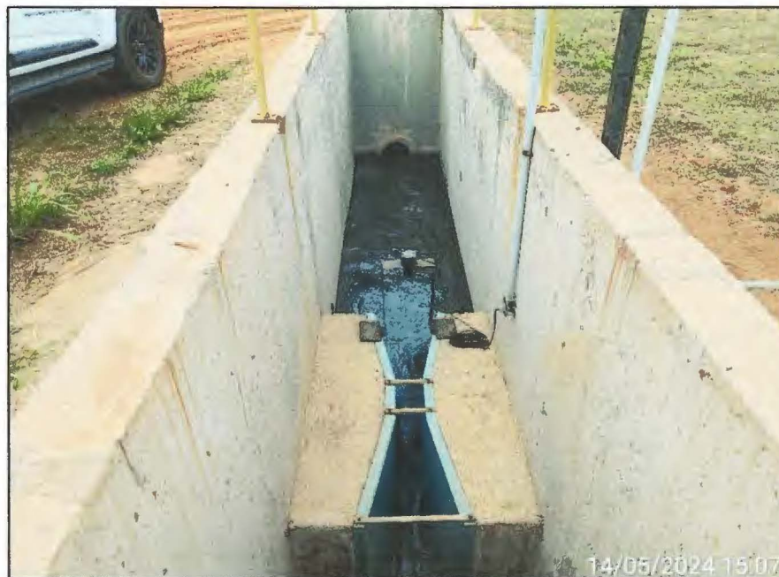
Imagem 07: Detalhe do local da saída do tratamento da ETE Rio das Mortes – 14/05/2024.
