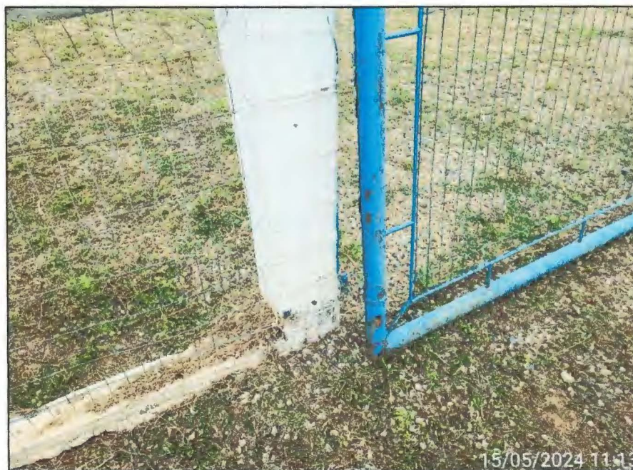
Imagens 28: Detalhe do portão de acesso danificado na unidade PTP 07.
