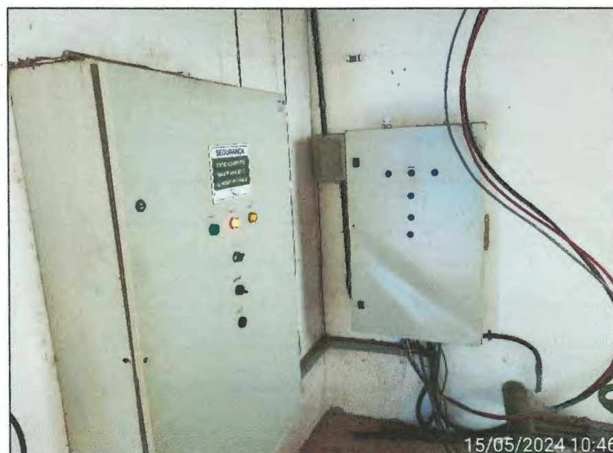
Imagem 24: Detalhe das fiações elétrica na casa de máquinas da unidade Santa Rosa.
