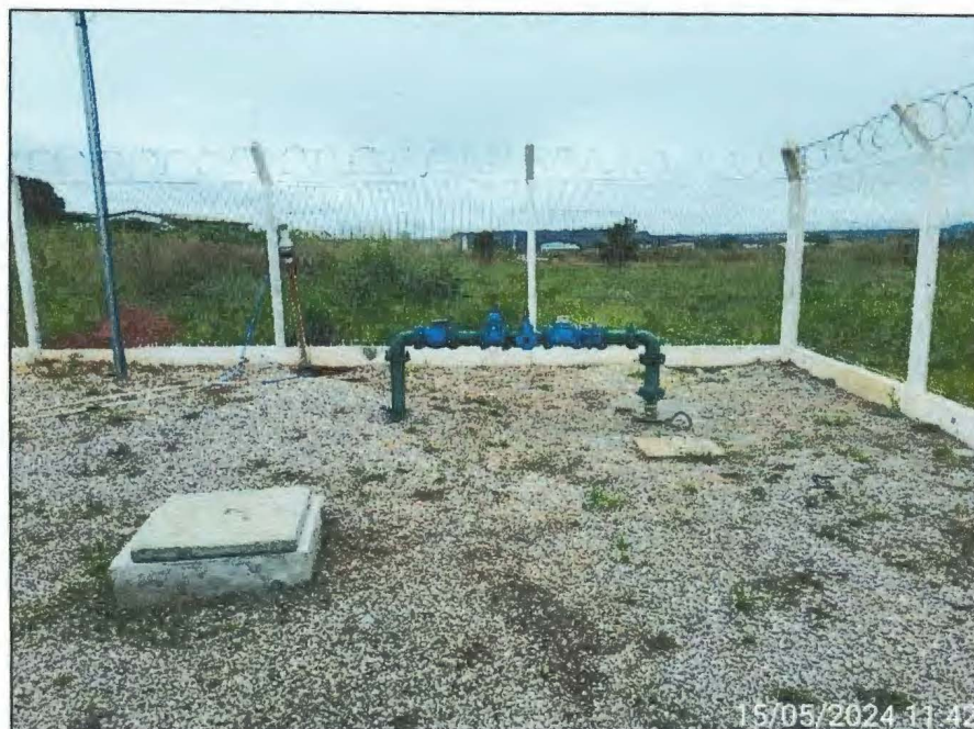
Imagem 37: Detalhe da ausência de medidor de vazão no PTP J. Ville.
