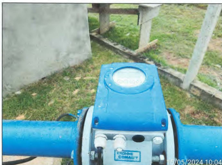
Imagem 15: Detalhe do macromedidor danificado na unidade PTP 14.
