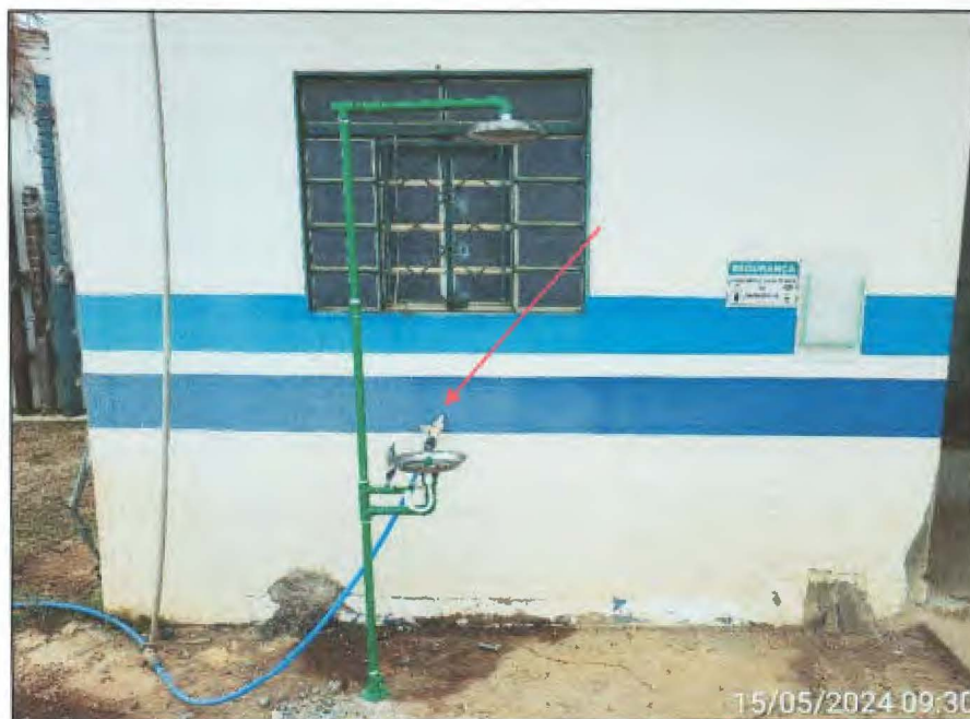
Imagem 04: Detalhe do chuveiro e lava olhos de emergência e, destaque para a canalização de água desligada do equipamento na unidade Sede.
