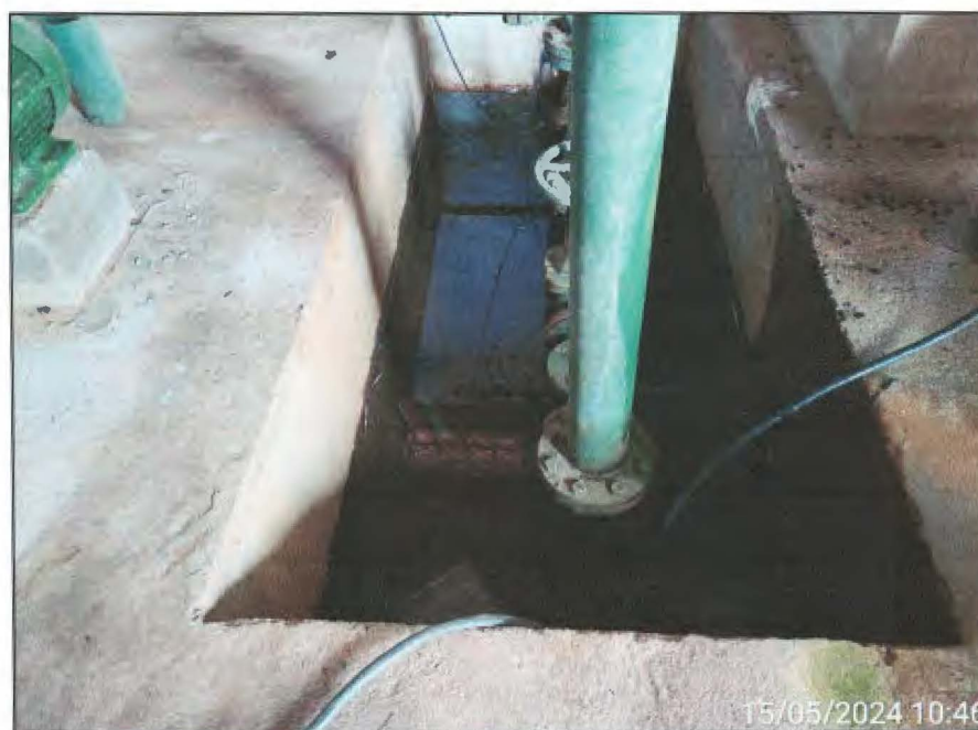
Imagem 22: Detalhe da caixa do barrilete na casa de máquinas com água acumulada – Unidade Santa Rosa
