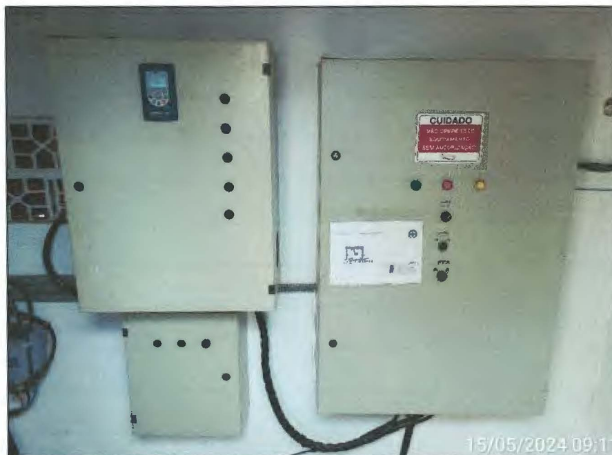
Imagem 40: Detalhe dos quadros de comando da unidade Sede.
