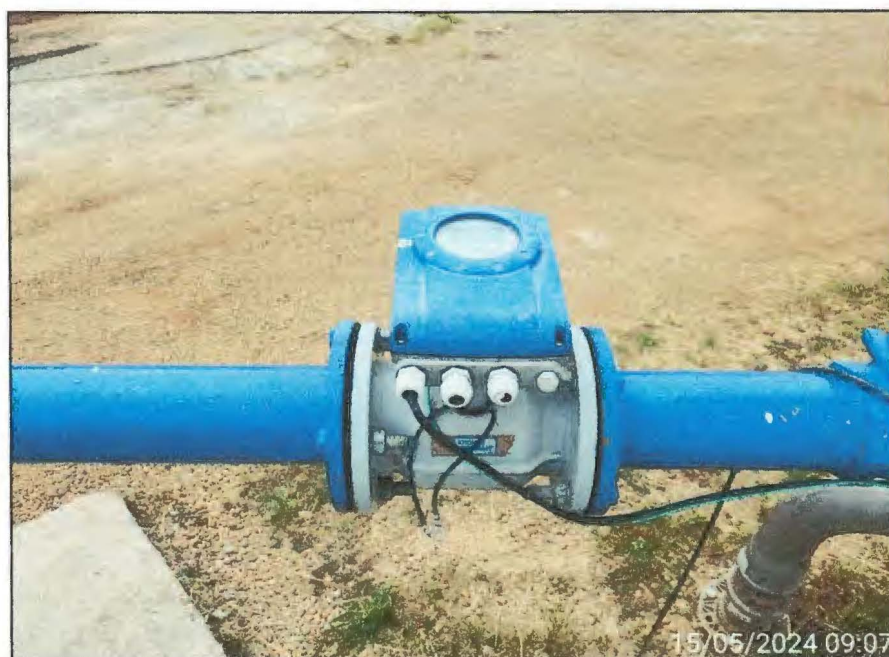
Imagem 02: Detalhe do macromedidor do PTP Sede com falha funcional.
