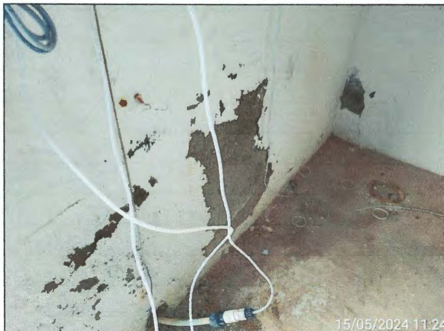
Imagem 33: Detalhe das paredes danificadas da casa de química na unidade Belvedere.
