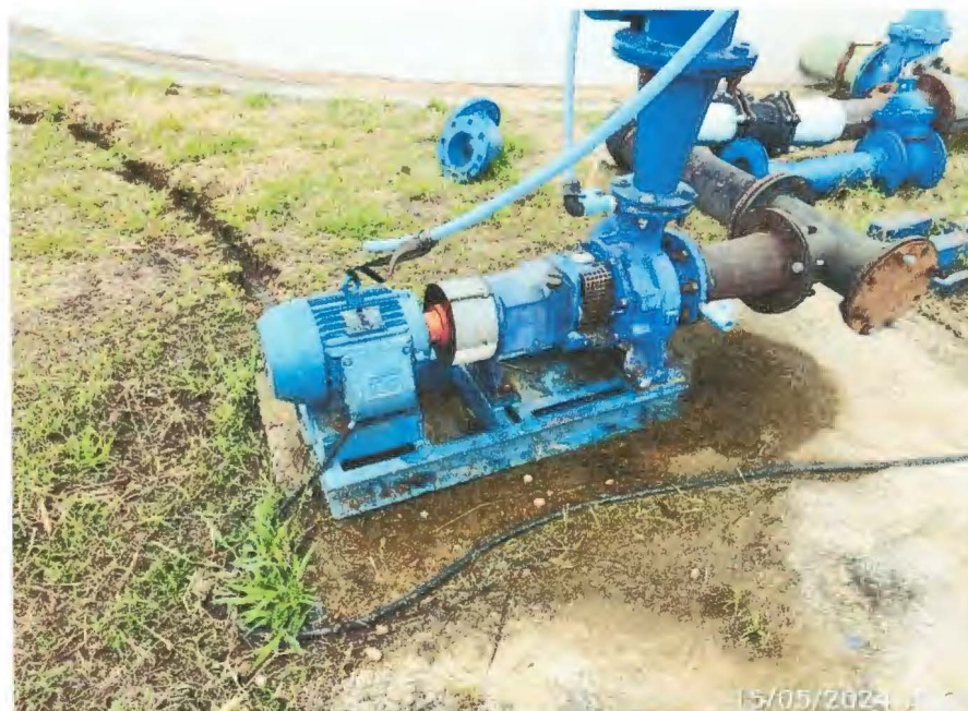
Imagem 20: Detalhe da ausência do conjunto motobomba reserva na EAT 01 da unidade Campo Real.
