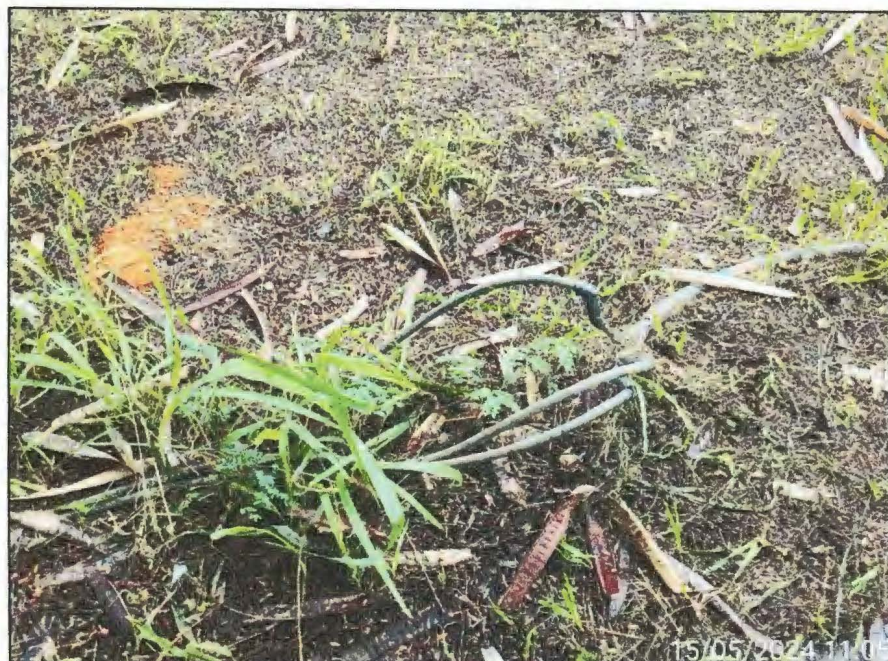
Imagem 27: Detalhe das fiações elétricas expostas no pátio da unidade PTP 04.
