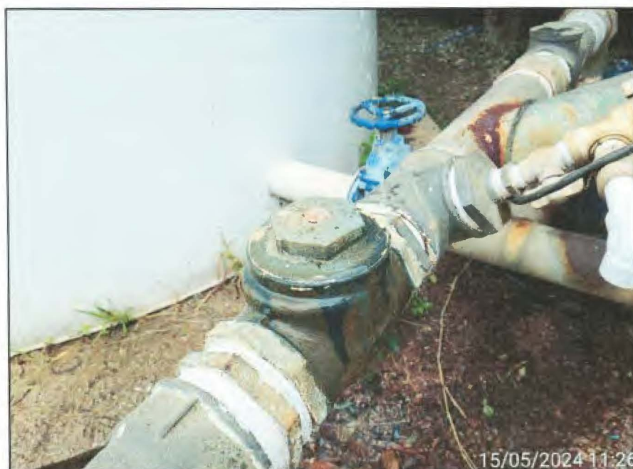
Imagem 32: Detalhe do vazamento no barrilete da EAT Belvedere.
