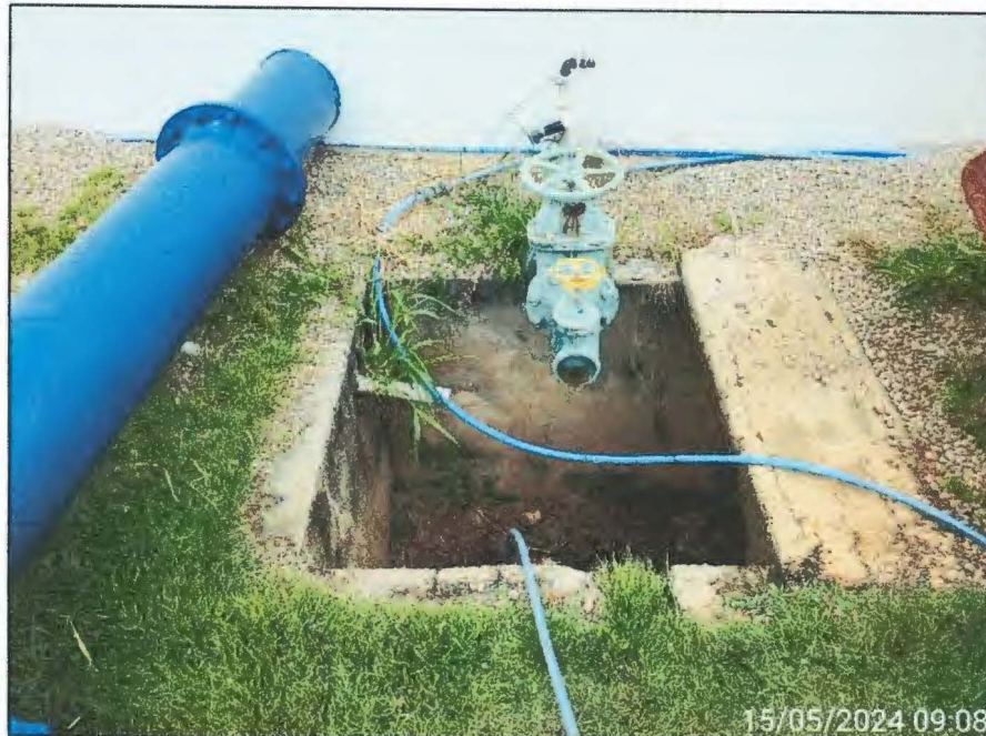
Imagem 03: Detalhe da caixa de passagem sem grade ou tampa de proteção na unidade Sede.
