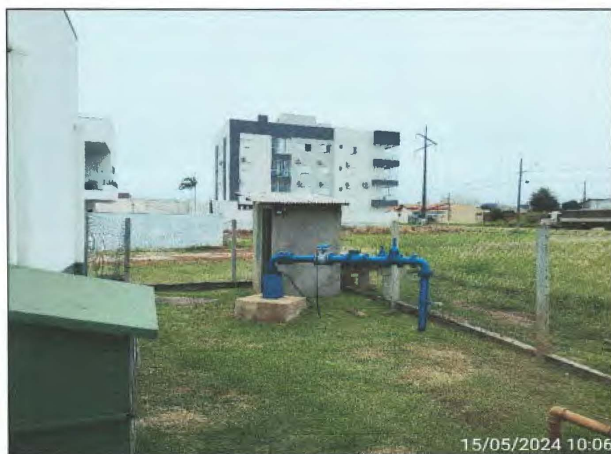
Imagem 16: Detalhes da ausência de extintor de incêndio e sistema para comunicação com o CCO na unidade PTP 14.
