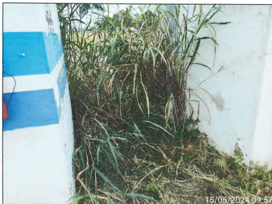
Imagem 13: Detalhe do excesso de vegetação na unidade PTP 02
