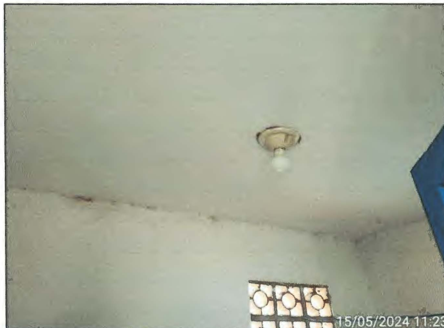
Imagem 30: Detalhe da lâmpada danificada na sala de comando da unidade Belvedere.
