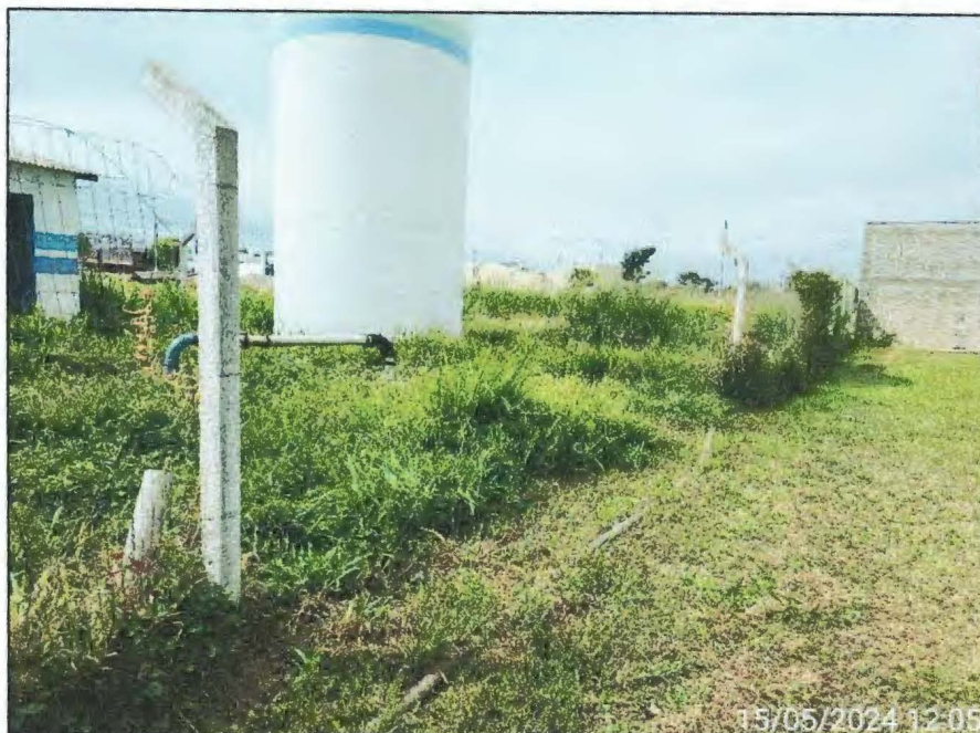
Imagem 39: Detalhe da ausência de parte do alambrado na unidade Buritis.
