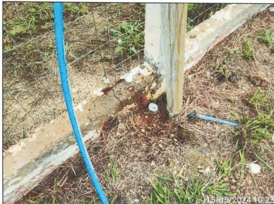
Imagem 19: Detalhe do vazamento na dosadora causando danos a estrutura do alambrado na unidade Campo Real.
