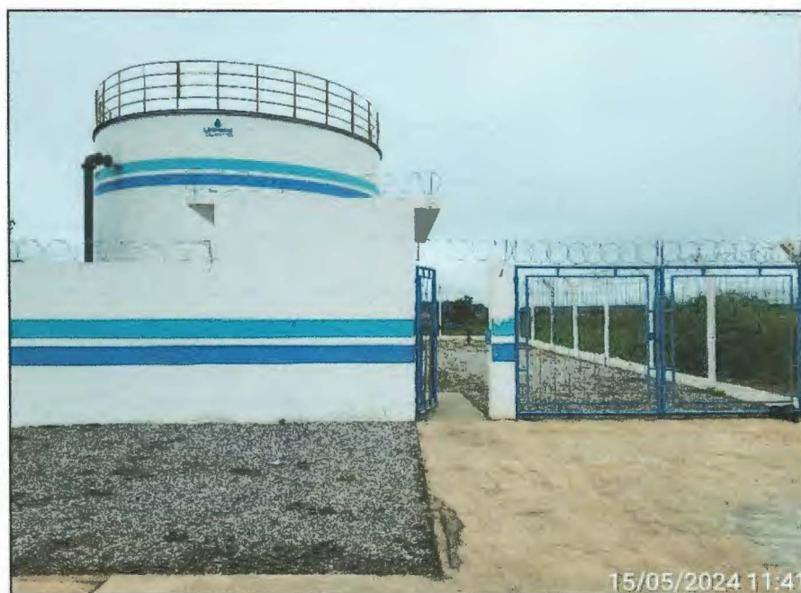
Imagem 36: Detalhes da ausência de placa de identificação e de sistema de comunicação com o CCO na unidade J. Ville.
