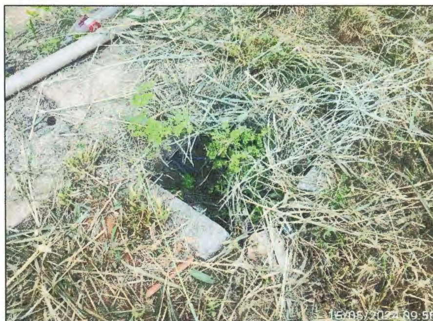
Imagens 10: Detalhe da caixa de passagem com ausência de grade ou tampa de proteção no pátio da unidade PTP 02.
