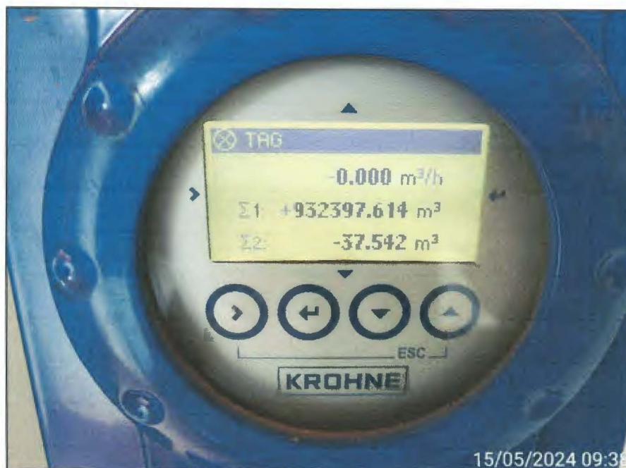
Imagem 05: Detalhe do visor do macromedidor do PTP 06 com falha funcional.
