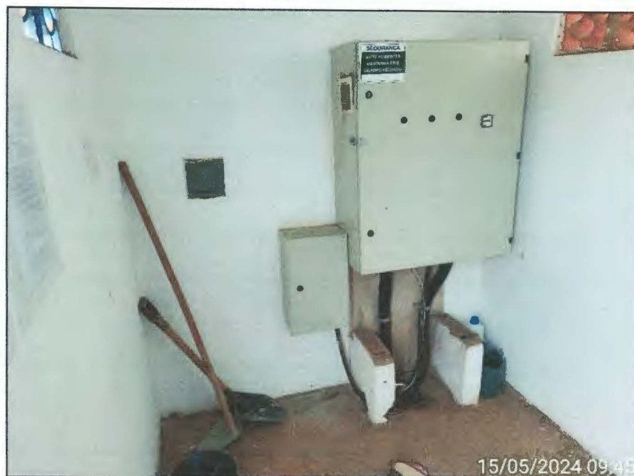
Imagem 07: Detalhe da sala de comando da unidade PTP 05.
