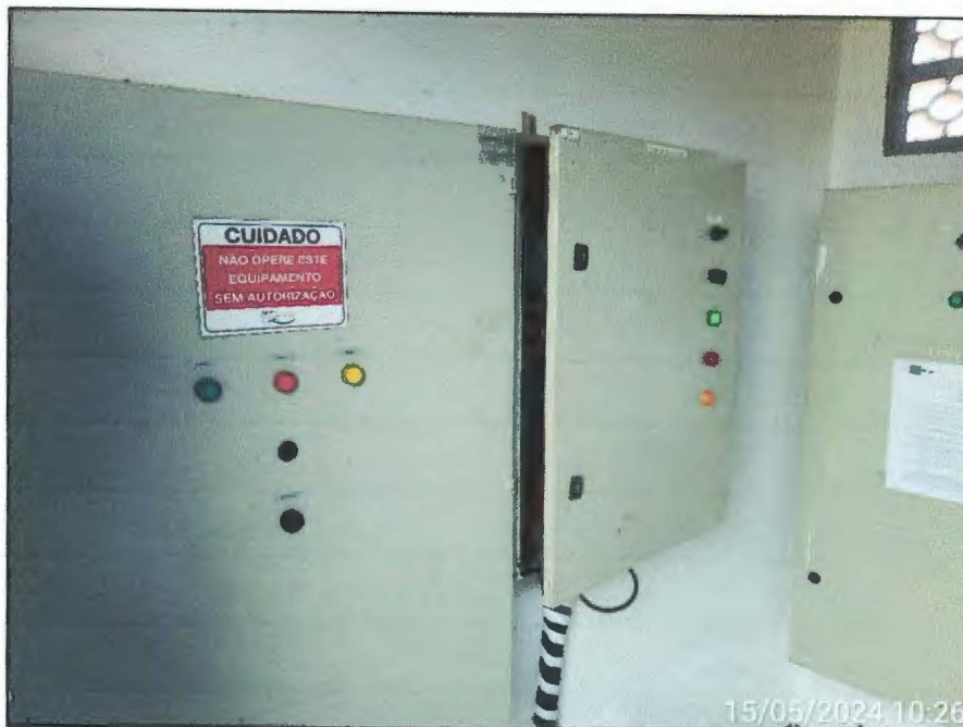
Imagem 41: Detalhe dos quadros de comando da unidade Campo Real.
