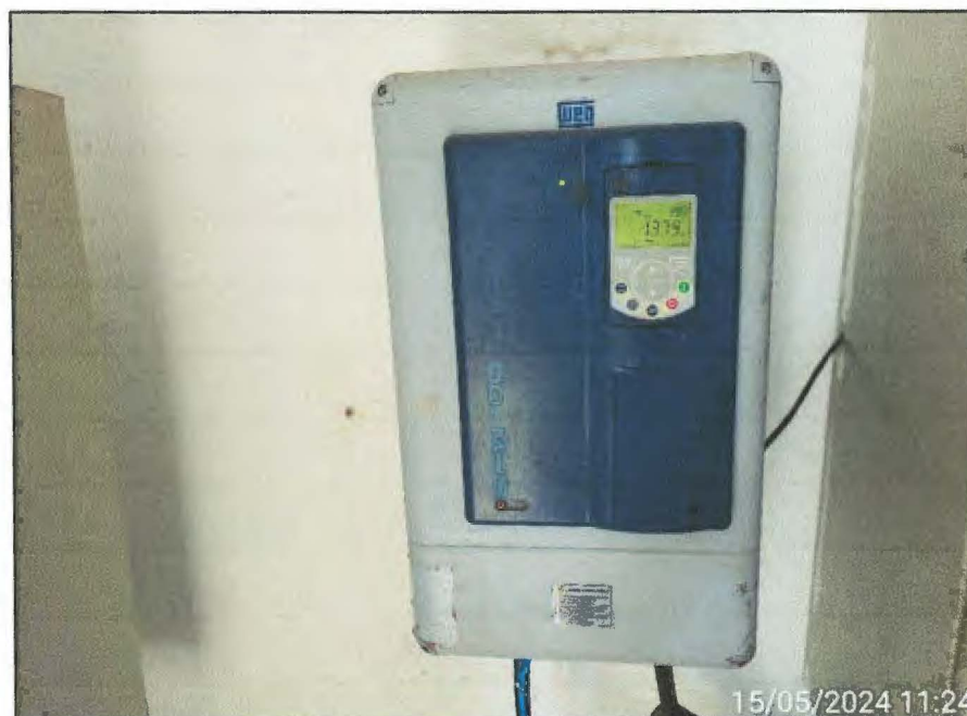
Imagem 34: Detalhe do inversor de frequência da EAT Belvedere.
